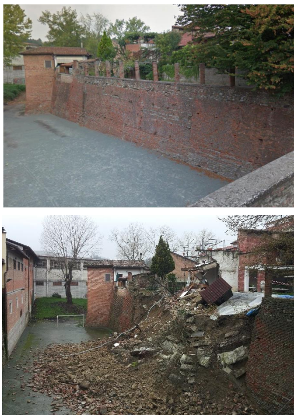
Antico muro di cinta prima del dissesto (Google Street View 2011) e dopo l'evento (25.03.2015).
