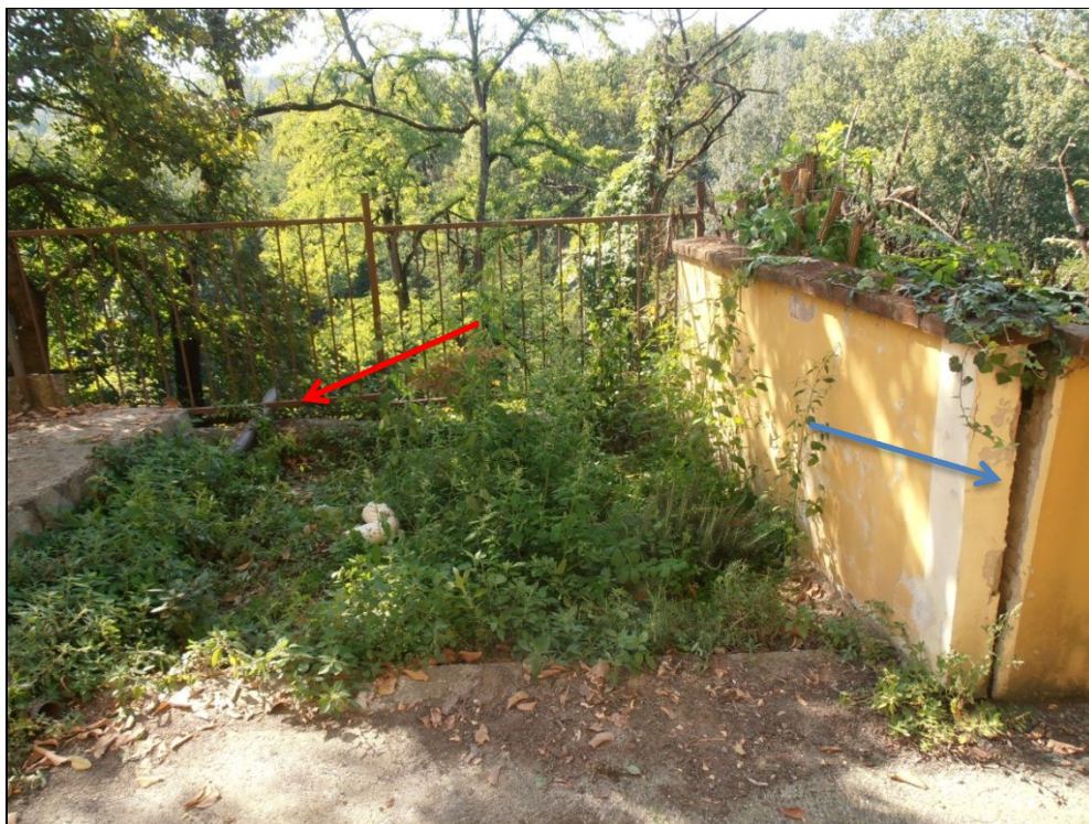
Figura 4: Stato di fatto – In evidenza i cedimenti del parapetto di valle (freccia blu) ed i tubi di scarico delle acque cortilive, non regimati, direttamente sulla scarpata (freccia rossa).
