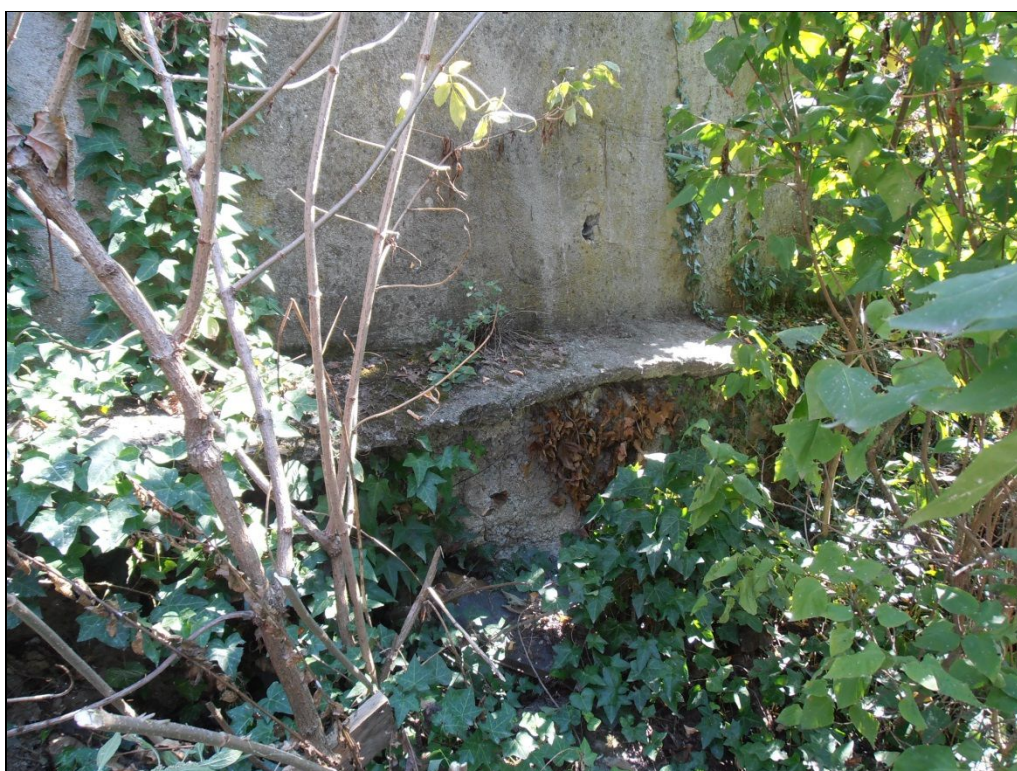
Figura 6: Stato di fatto – In evidenza lo scalzamento del muro di sottoscarpa esistente in corrispondenza dell'edificio al margine sud del tratto considerato..
