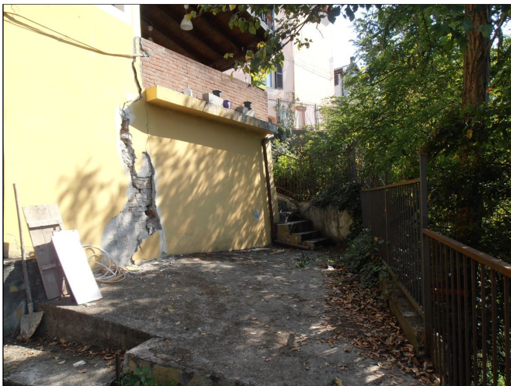
Figura 5: Stato di fatto – In evidenza le fessurazioni sulla parete frontale dell'edificio centrale in corrispondenza dell'attacco di un avancorpo.
