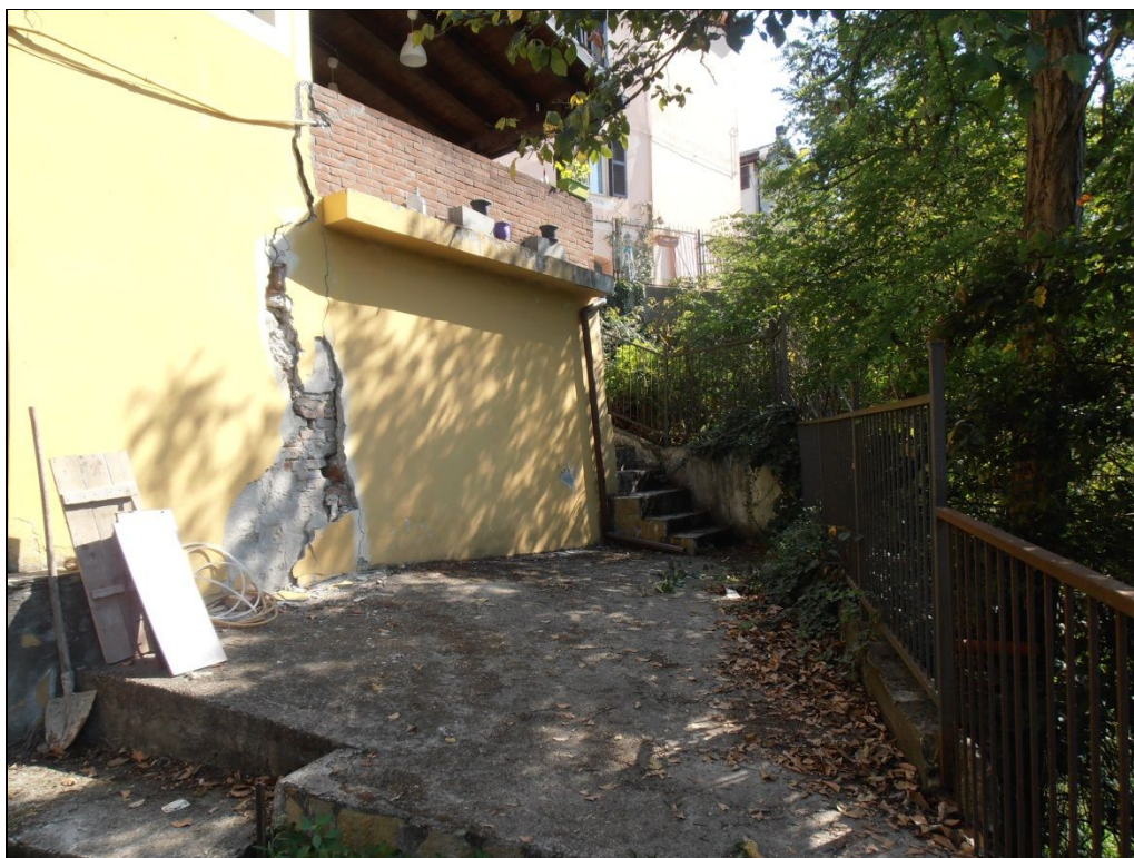
Figura 9: Stato di fatto – In evidenza le fessurazioni sulla parete frontale dell'edificio centrale in corrispondenza dell'attacco di un avancorpo.
