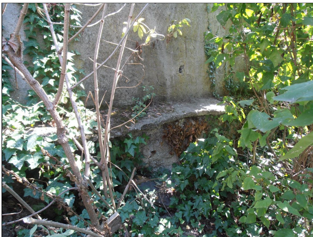
Figura 10: Stato di fatto – In evidenza lo scalzamento del muro di sottoscarpa esistente in corrispondenza dell'edificio al margine sud del tratto considerato..
