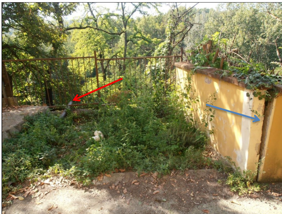
Figura 8: Stato di fatto – In evidenza i cedimenti del parapetto di valle (freccia blu) ed i tubi di scarico delle acque cortilive, non regimati, direttamente sulla scarpata (freccia rossa).
