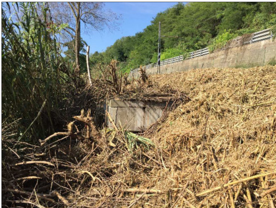
Figura 15: Pozzettone in sponda sinistra recapitante le acque fognarie comunali al depuratore
