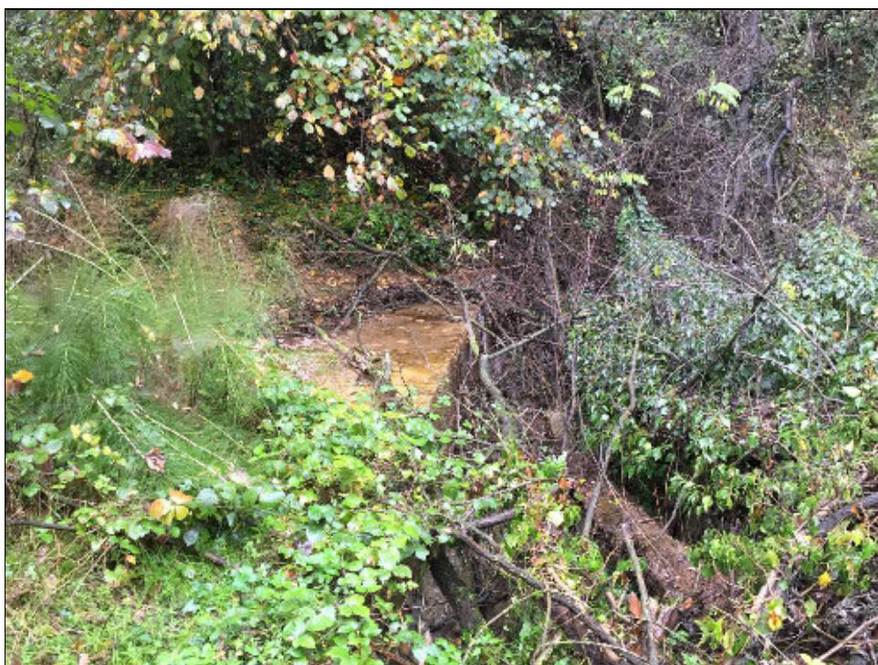
Figura 9: Particolare della gaveta della briglia in c.a. esistente trasversalmente al Rio Crosio nel settore di monte. Si evidenzia la presenza di tronchi e ramaglie a ridosso del manufatto.
