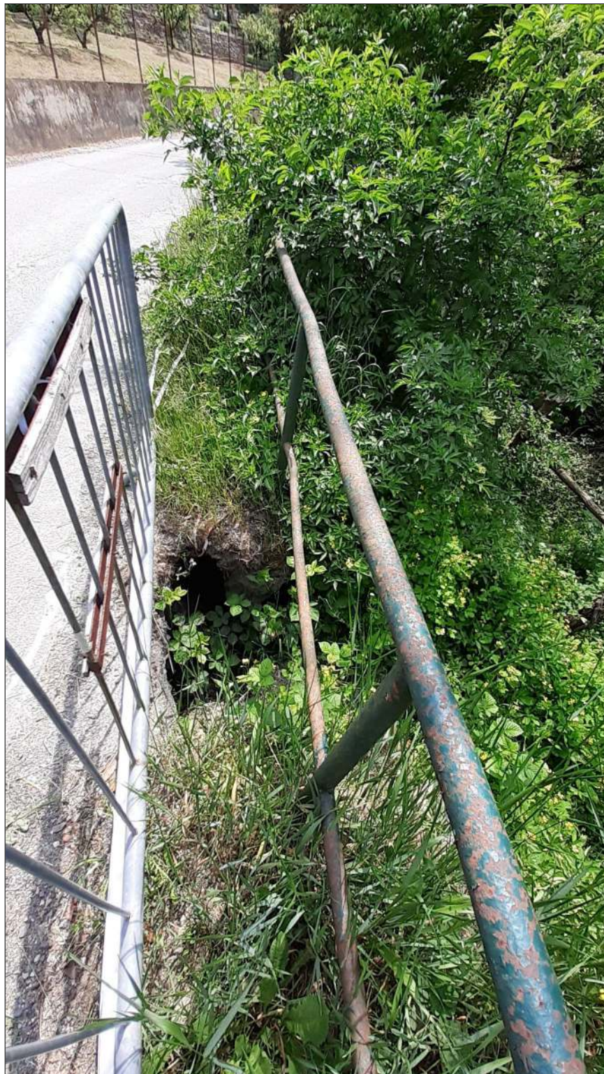
Vista tratto di strada mediano interessato dal dissesto – intervento 1
