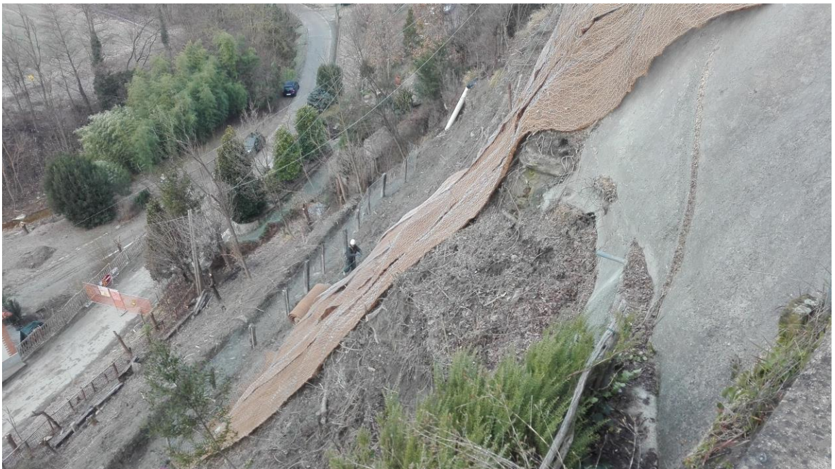
FOTO 1-2 DISSESTO RELATIVO AD INTERVENTO 2 E OPERE PROVVISORIE REALIZZATE
